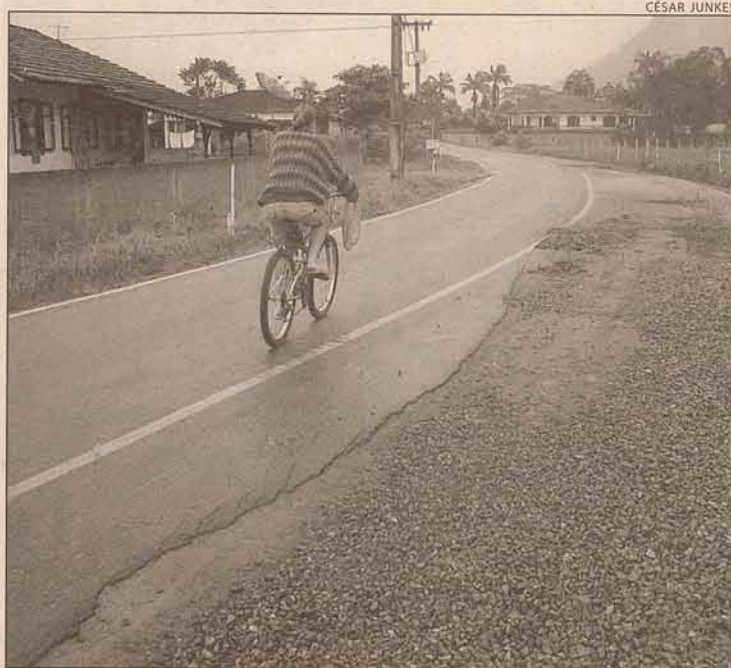
Moradores se arriscam para desviar da pista danificada
