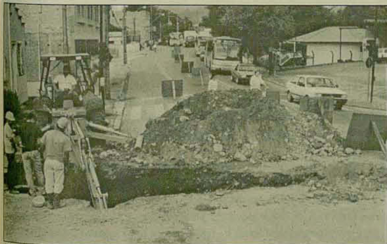
Paciência: motoristas enfrentam congestionamento por causa do esgoto
