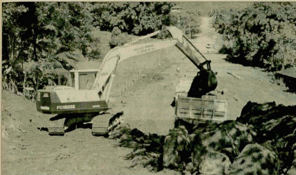
Obra: o chamado Morro da Argi é o trecho mais difícil do traçado da Rua Luiz Feliciano Bortolini
