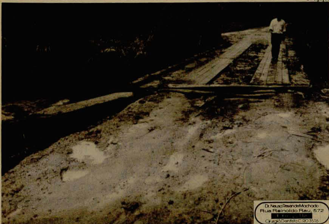
Ponte avariada em Ribeirão Grande do Norte
